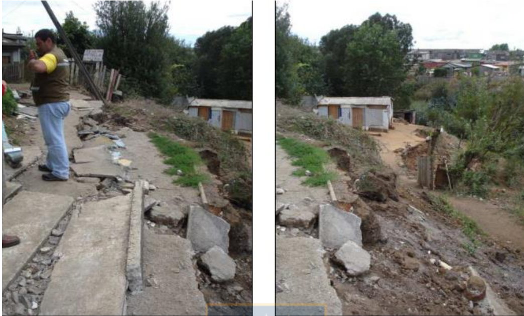
Figura 9.7. Grietas, hundimientos y deslizamientos de suelo en el sector de Villa La Ilusión, comuna de Lota, región del Biobío.
