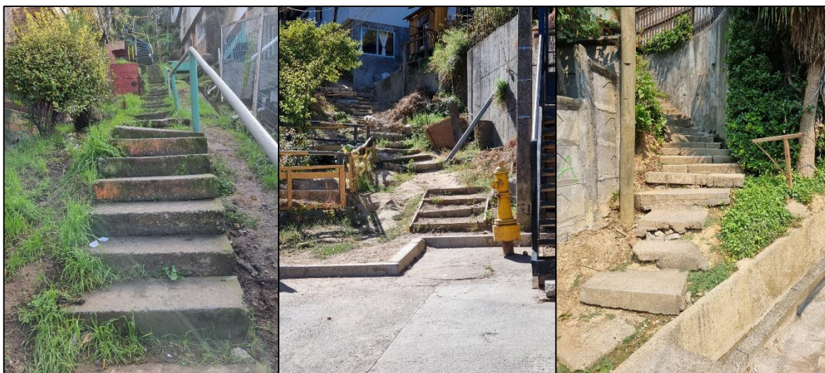
Figura 61: Escaleras en mal estado
