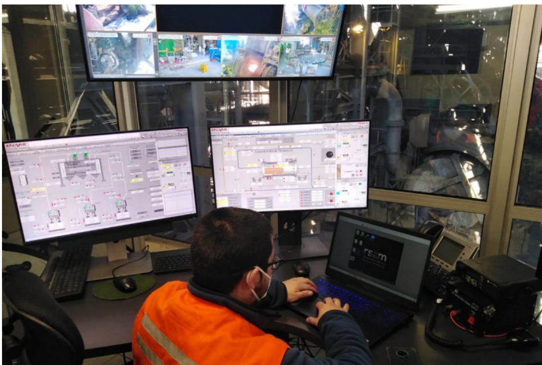
Figura 1.3.1: Fotografía monitoreo temperatura desde sala de control Fundición HVL, Paipote, por parte del equipo de RS2M
