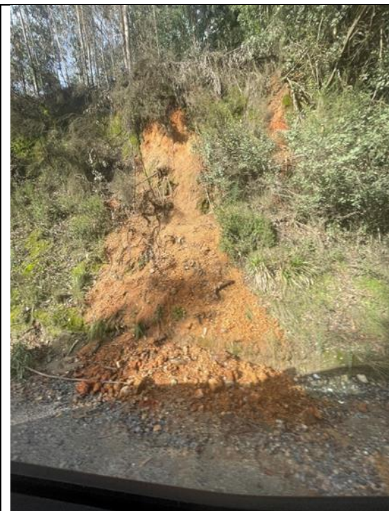
Deslizamiento de tierra entre los sectores Paso de Piedra/Maqueuto
