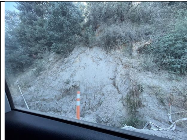
Caída de rocas en sector La Leonera
