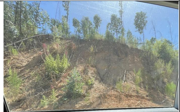
Deslizamiento de tierra en la ruta O-722, camino sector Bulnes
