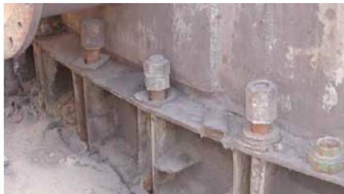
Figura 2.2 Fluencia de pernos de anclaje producto del sismo del año 2010 (Montecinos, 2012)
