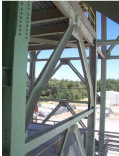
Figura 2.3 Pandeo local y global producto del sismo del año 2010 (Montecinos, 2012)
