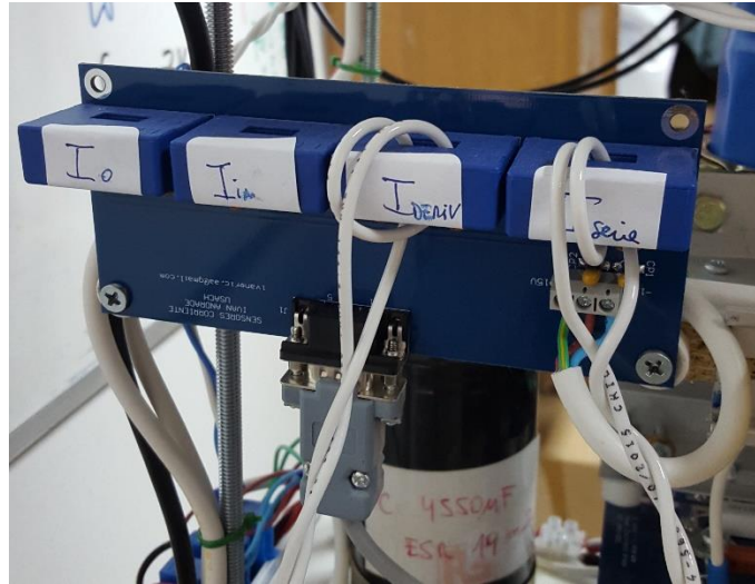
Figura 5.9: Fotografías de una tarjeta de medición de corrientes, con capacidad para cuatro mediciones de corriente.
