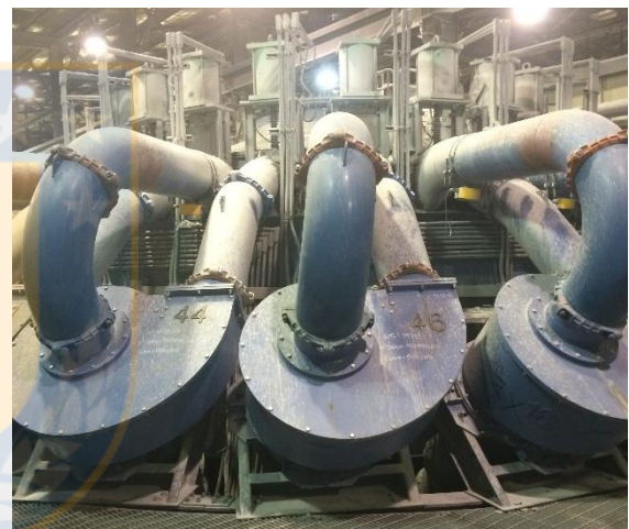
Figura 3.3 Batería de hidrociclones
