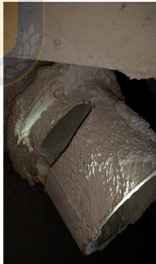
Figura 4.16 Hidrociclón con porta ápex desgastado.
