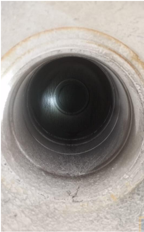
Figura 4.13 Hidrociclón 11 en condiciones normales.
