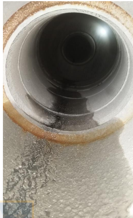
Figura 4.14 Hidrociclón 13 en condiciones normales
