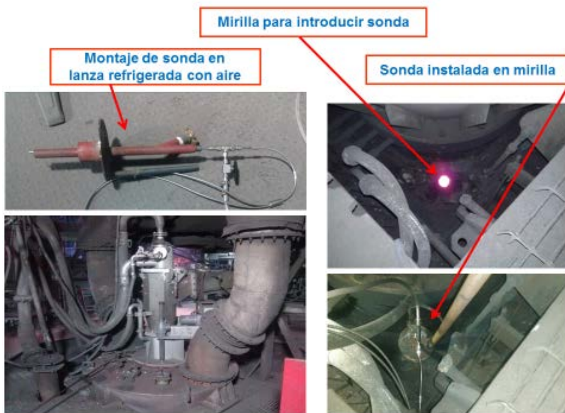
Fig.5. 4 Sonda instalada en HFF de fundición Chagres.
