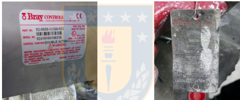
Figura N° 77 Válvula de adición de lechada de cal utilizada actualmente en planta concentradora DAND.
