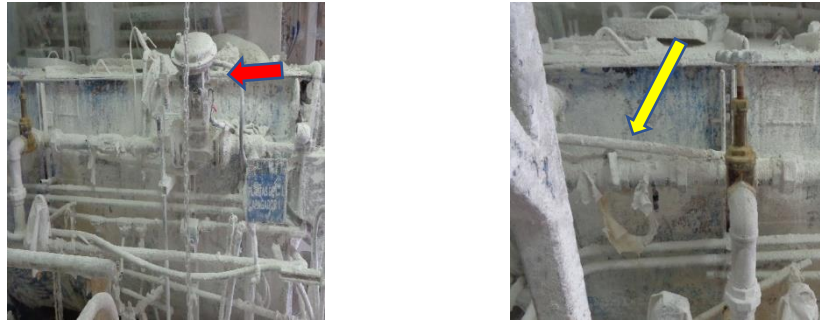
Figura N° 76 Alimentación agua slaker N°1, planta de cal N°1.
