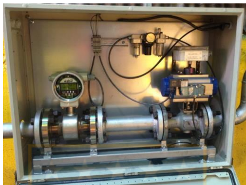
Figura 3-2. Flujómetro y válvula automática en manifold para adición de reactivo FLOMIN D633 a TK preparador.
