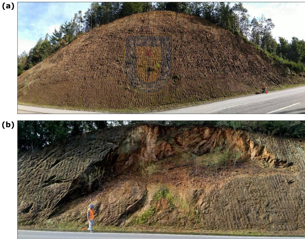
Figura 3.2: Casos de estudio. (a) Talud A estable. (b) Talud B inestable.
