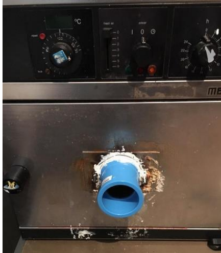
Figura 14: Conexión adaptada a la fuente de calor.
