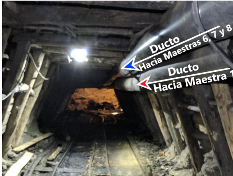
Figura 32: ductos en maestra principal.
