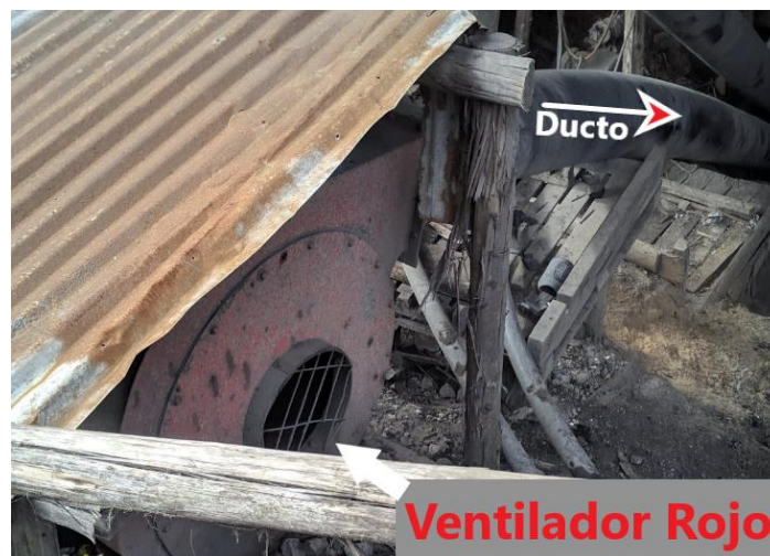
Figura 31: ubicación y ducto del ventilador rojo.
