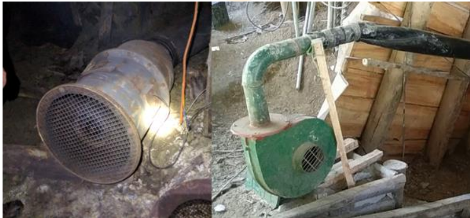
Figura 10: ventilador interior y exterior mina.
