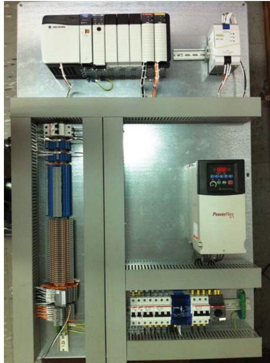
Fig. 3.11 PLC cableado y alimentado.
