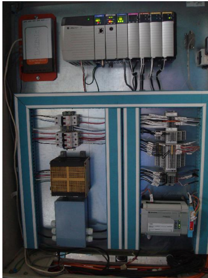
Fig. H.2. Gabinete del PLC
