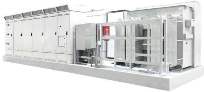
Fig. 4.10 Vista del gabinete más transformador de una unidad de 1MW real (HEC-US PLUS - 400V).
