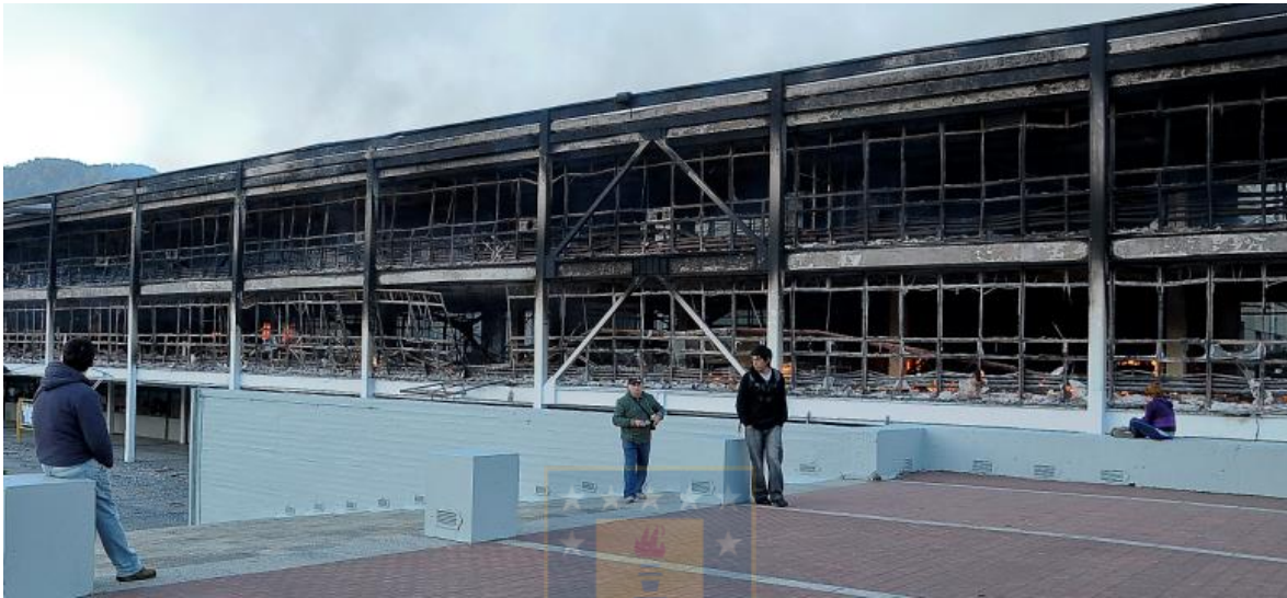
Fig. 52. Edificio Cs. Químicas siniestrado, bases técnicas – Concurso Anteproyecto de Arquitectura Reconstrucción Edificio de Laboratorios Facultad de Ciencias Químicas Universidad de Concepción.
