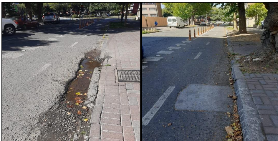
Imagen 55. Ejemplo de tramos deficientes - Ciclovía Barros Arana
